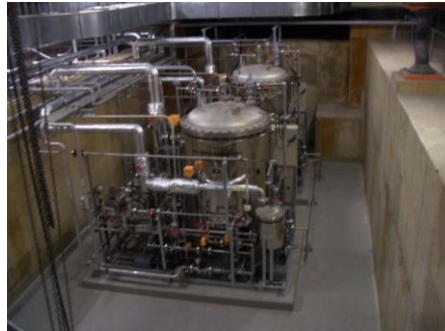
(改修後) 感染排水処理設備（省エネ型）
