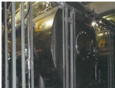
(改修前) 感染排水処理設備
