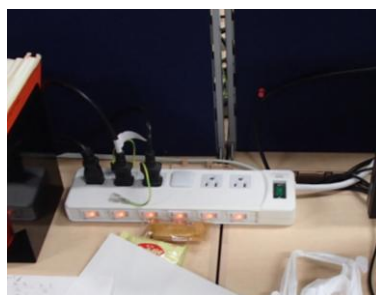
写真2. スイッチ付きOAタップにて待機電力カット
