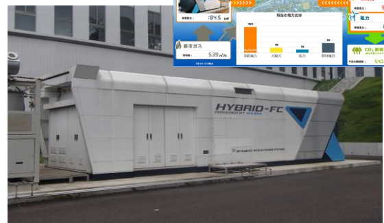
300kW 燃料電池発電設備
