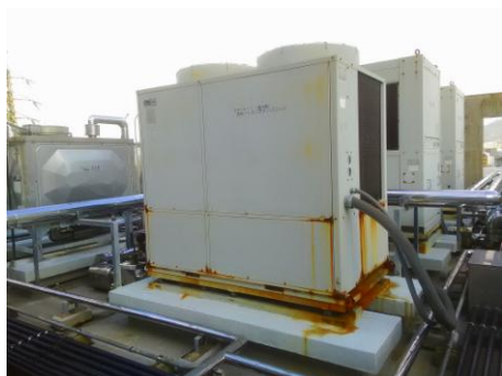
(改修前) 冷温水チラー
