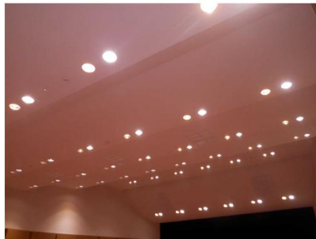
(改修後) LED照明
