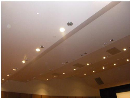
(改修前) 蛍光灯
